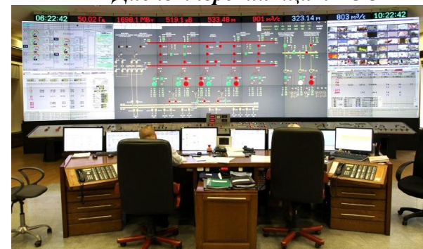
Диспетчерский щит ГЭС
